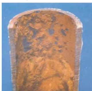
Ocelové potrubie s koróziou
